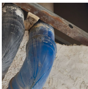
Foto 2 - Escorrimento de água pelo tubulação
