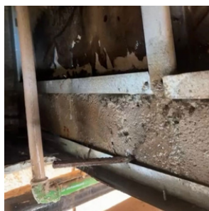
Foto 4 - Patologia na parede pela umidade
