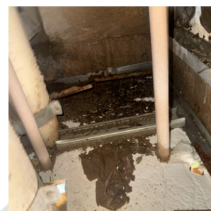
Foto 3 - Acúmulo de umidade e sujeira
