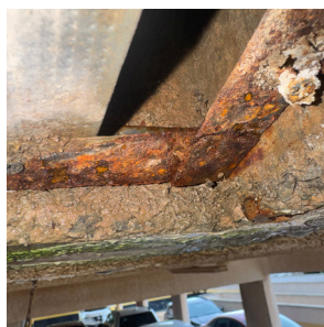
Foto 5 - Corrosão avançada pelo contato com umidade
